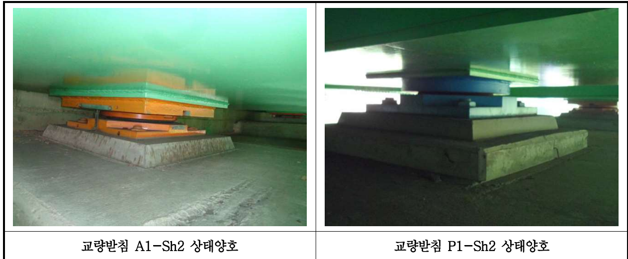
【사진 24.3.13】 교량받침 손상현황
